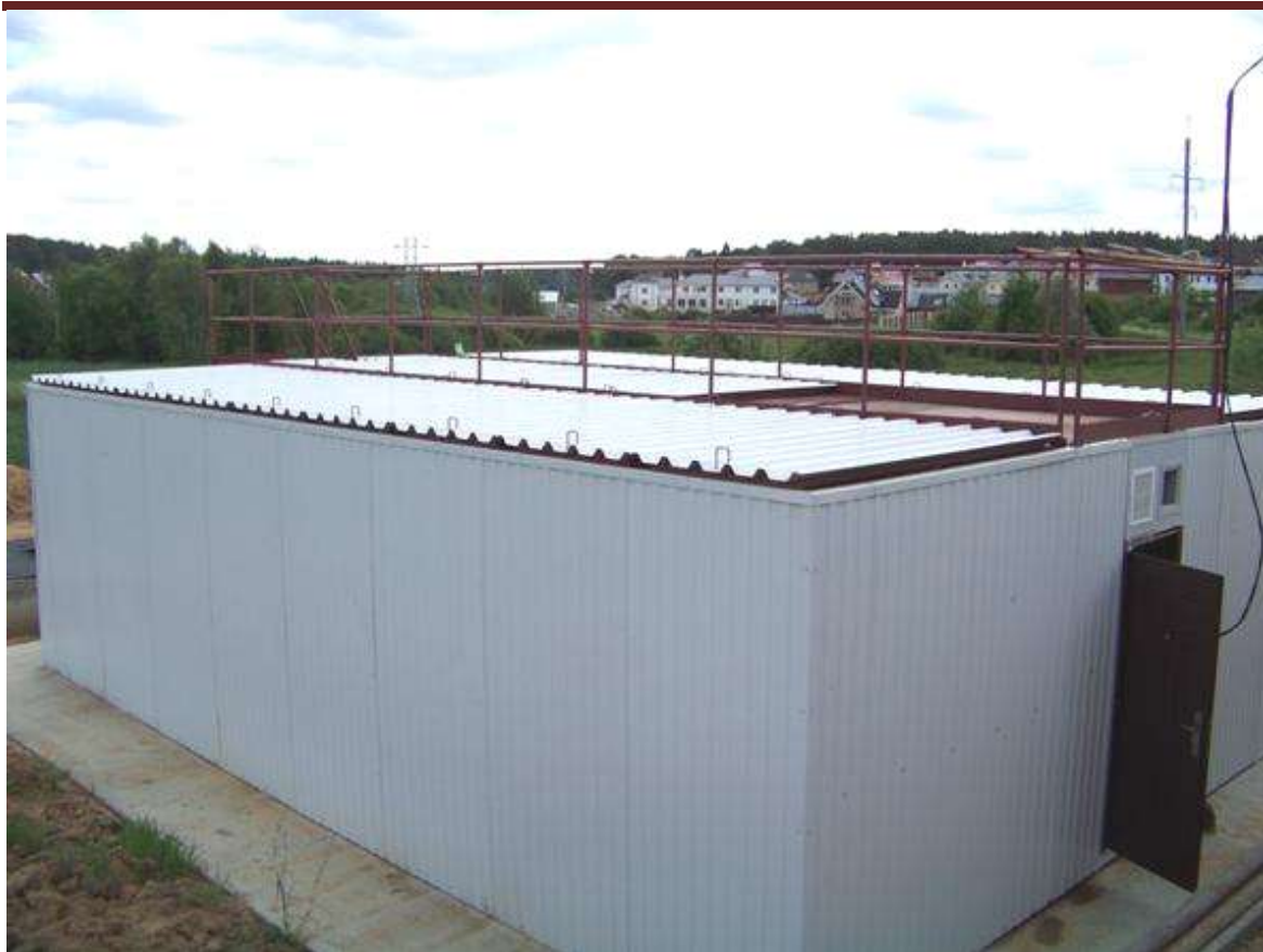
Рисунок 10. Внешний вид очистных сооружений «Биоресурс»
